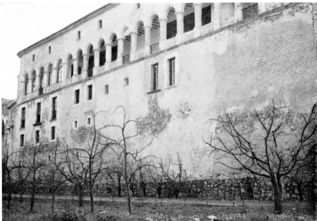
Estado actual de la fachada exterior de las Casas Nuevas de Poblet.
